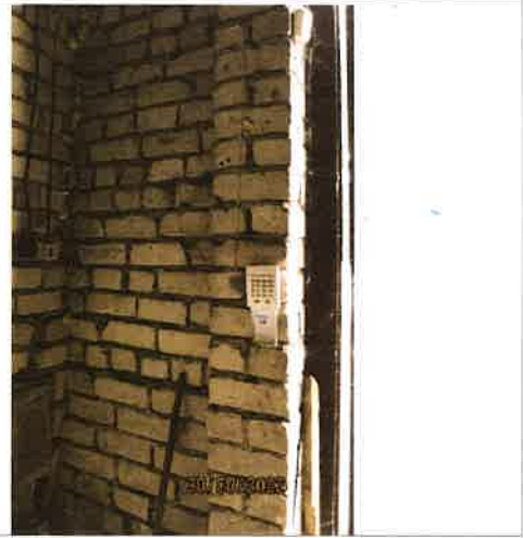
Apsardzes iekārta garāžā.
