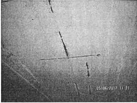
Fotofiksācija Nr. 7 Pagrabstāvā dzelzsbetona pārsegumam korodējusi armatūra un bojāta aizsargkārtā
