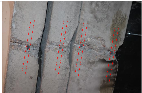
4.24.att. Atsegums ailu pārsedzē ar konstatēto stiegrojumu
