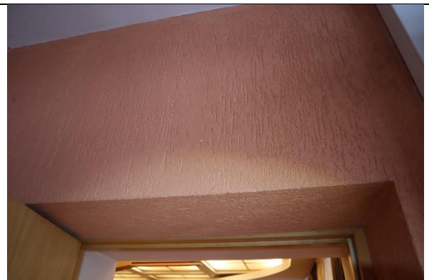
4.11.att. Patvaļīgi izbūvēta aila starp telpu Nr.7 un Nr.8
