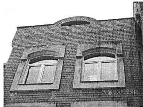
Fotofiksācija Nr. 4 Fasādes apdares un ķieģeļu izdrupumi ēkas DR fasādē
