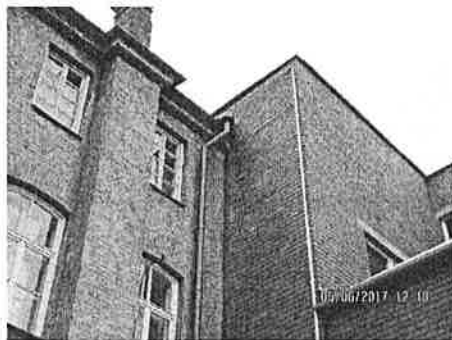
Fotofiksācija Nr. 5 Ķieģeļu izdrupumi ēkas fasādē
