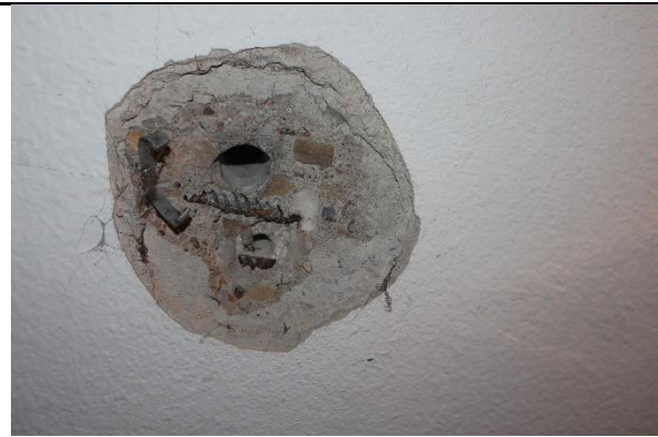
4.32.att. Betona aizsargslāņa bojājumi
