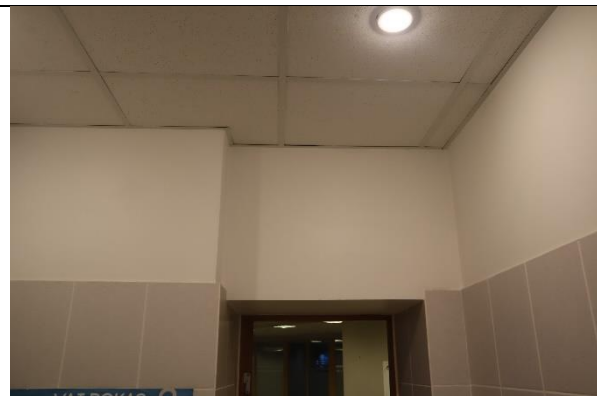
4.2.att. Patvaļīgi izbūvēta aila starp telpu Nr.6 un Nr.22
