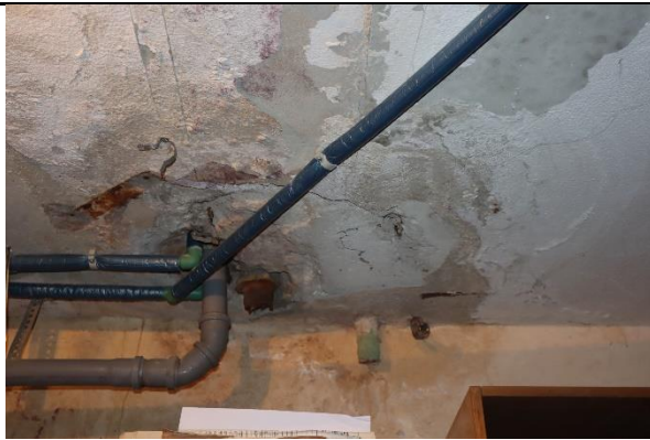
4.31.att. Inženierkomunikāciju šķērsojums pagrabstāva pārsegumā un betona aizsargslāņa bojājumi
